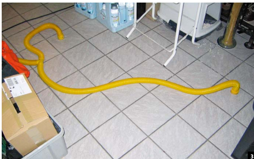
Abb. 3: Bei der Trocknung von Dämmschichten unter Estrichen wird seit nunmehr zehn Jahren fast nur noch im Unterdruck- oder Saugverfahren getrocknet. Hier wurden die Bohrungen mit einem Durchmesser von 50 Millimetern durch den Fliesenbelag gesetzt und die Saugschläuche miteinander verbunden. Um keine eventuell vorhandenen Keime freizusetzen, wird die feuchte Luft durch einen Filter geführt.
